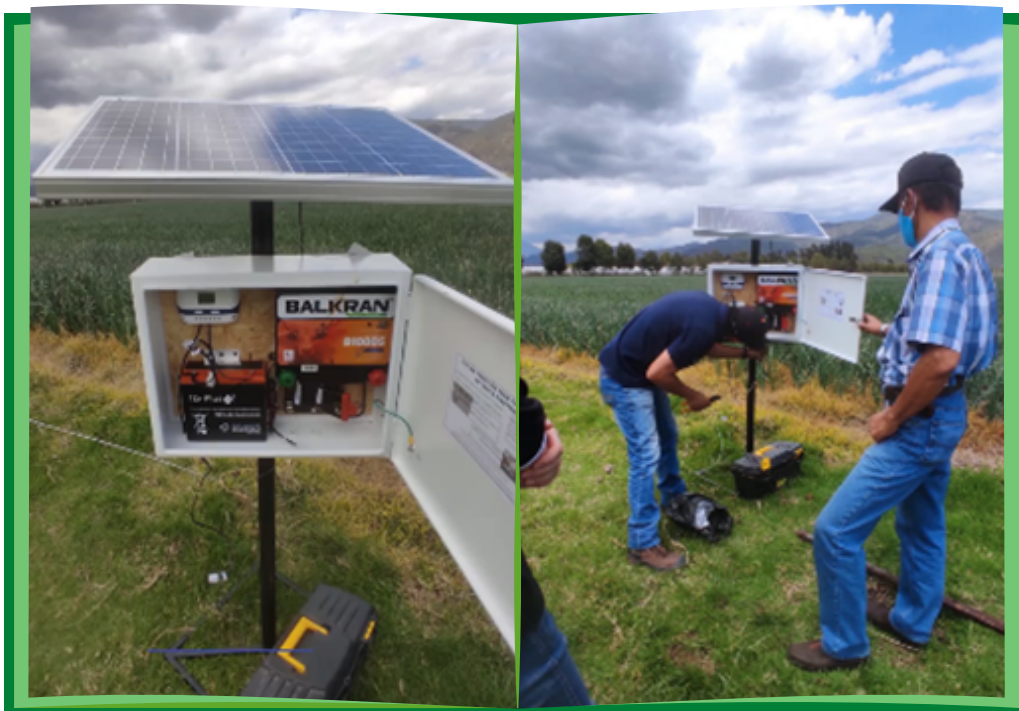
Registro fotográfico, instalación de KIT de energía solar Zetaquira
